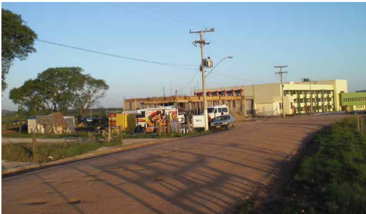
Acesso ao prédio da Unipampa, em Bagé, é feito ainda por estrada sem calçamento e esburacada.
