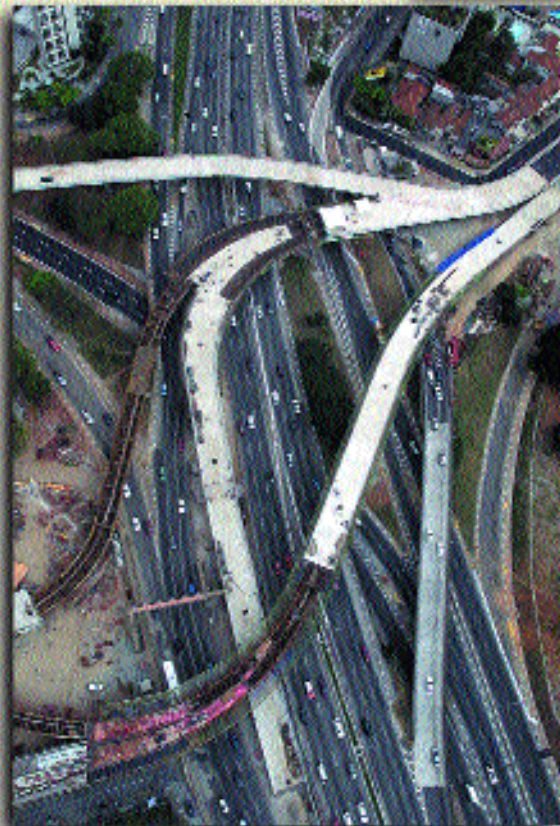
A construção (via pública inacabada) que morre na contramão atrapalhando o trânsito
